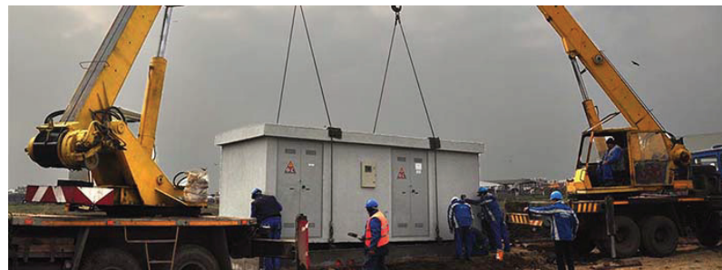
Poziționare post de transformare - Domarex `94 Călărași
